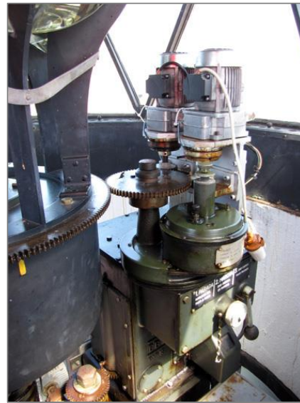
Sistema con motor eléctrico
